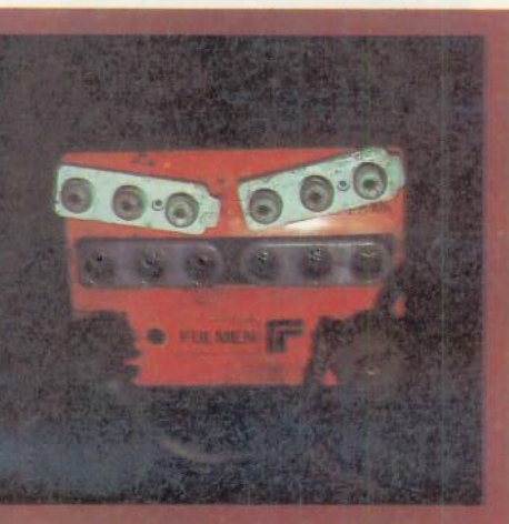
CONTROLE DU NIVEAU DE L'ELECTROLYTE, DE L'ETAT DES BORNES ET DES COSSES (CLICHE E.A.)
